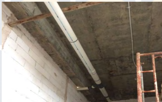
Gambar 2.7 Pipa PVC (Sumber : Pipa PVC yang ada di Grand Mall Batam)
