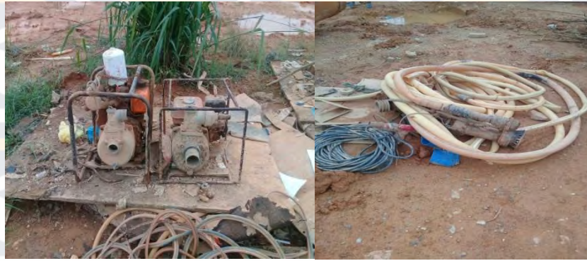
Gambar 4.12 Mesin Pompa Air dan Selang
